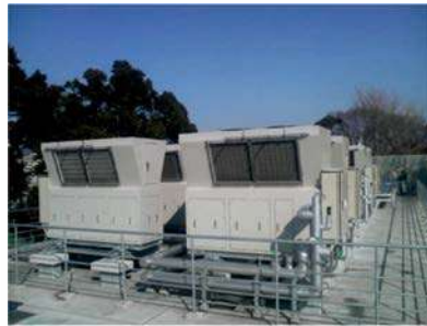
Figura 9. Nuevas enfriadoras con scroll hermético de amoníaco y condensadores convencionales.
